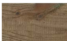
Rauhe Stellen auf der Holzoberfläche
