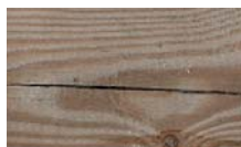
Spannungsrisse durch die Holz Trocknung
