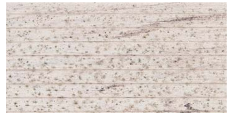
Stockflecken/Schimmel auf der Oberfläche
