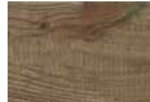
Rauhe Stellen auf der Holzoberfläche
