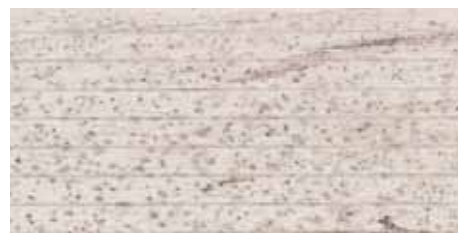
Stockflecken/Schimmel auf der Oberfläche
